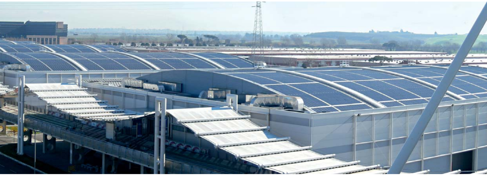
Rome Trade Fair: Eine 1,4 MWp große Photovoltaik-Anlage wurde auf die vorhandenen Dächer aufgebracht
