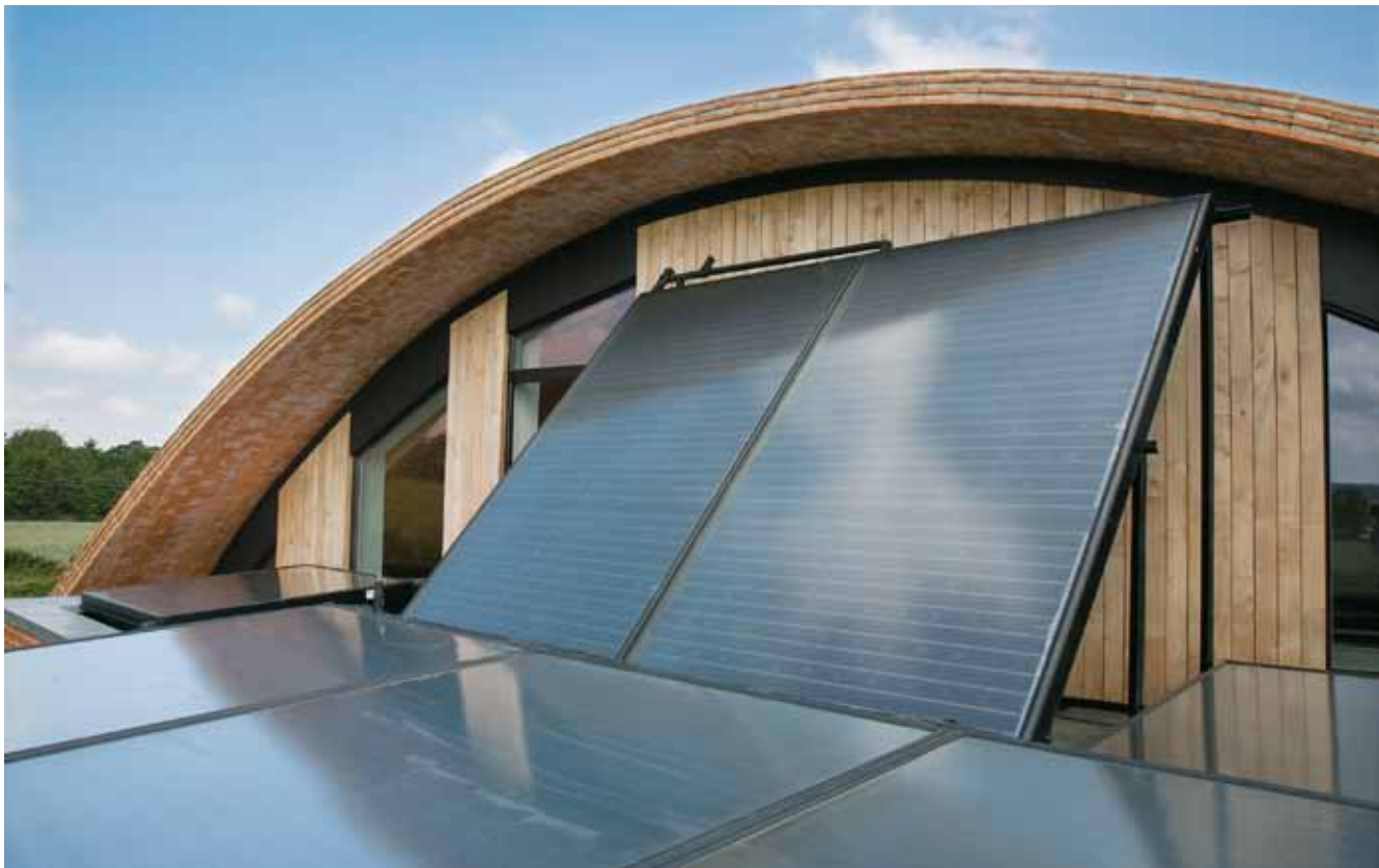
Ein neuer Trend im solaren Bauen: Hybridkollektoren, die Strom und Wärme erzeugen. Hier bei einem Gebäude in Crossways in der englischen Grafschaft Kent.
