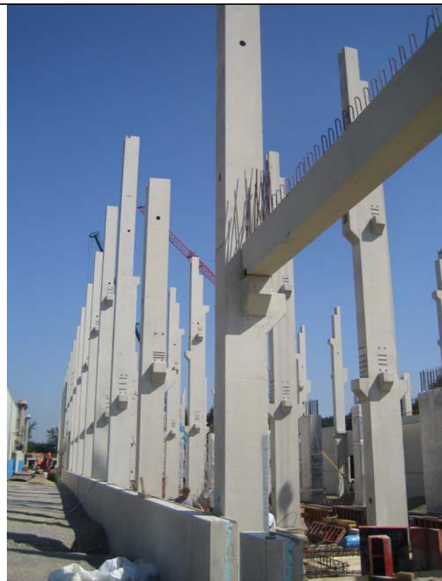
Bild 7 Rahmenausbildung auf der Großbaustelle Papierfabrik Hans Kolb PM4 in Kaufbeuren (Bildquelle PFEIFER)
